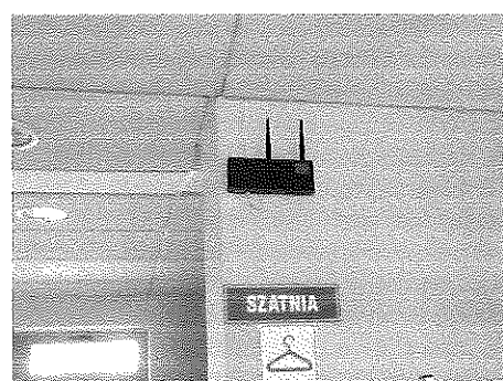
Zdjęcie nr 20: RouterBoard w budynku Pływalni miejskiej w Gubinie
